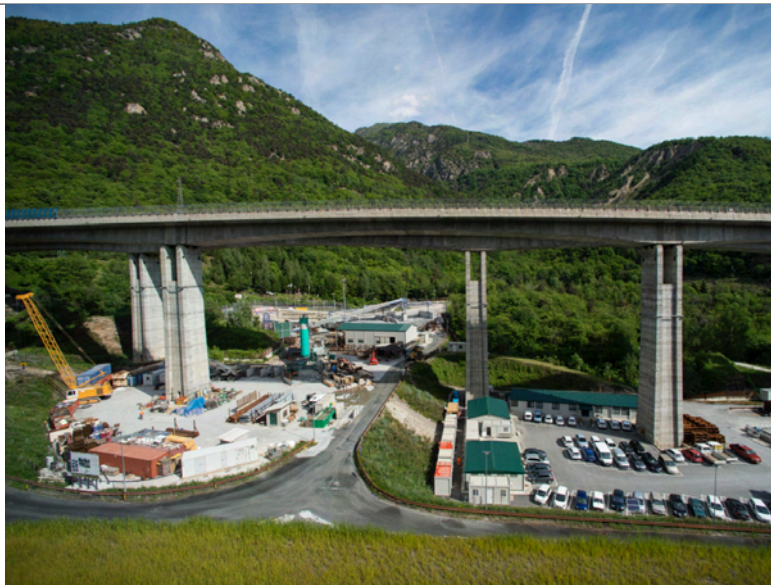
Il cantiere di Chiomonte, punto di partenza dei lavori del mega tunnel.
